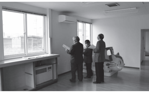
施設内に設置されたエアコン
