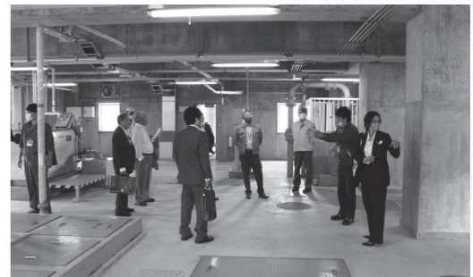
佐呂間別川へ放流される前の最終沈殿池
