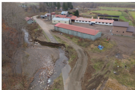
被害を受けた知来須佐地先道路
