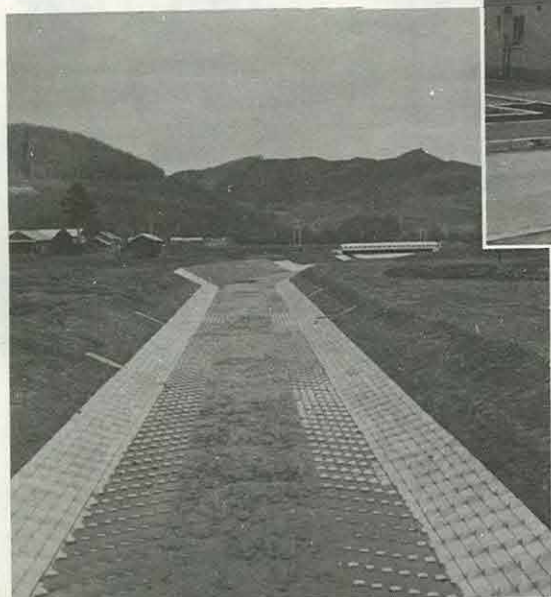
国営直轄明渠排水事業 (オンネルベシベ川)
